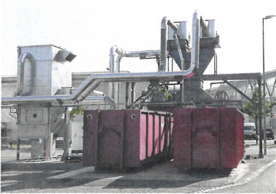
Umgebaute und erweiterte (Absaug-) Anlage in der Berner Druckerei. FOTO: NBS
