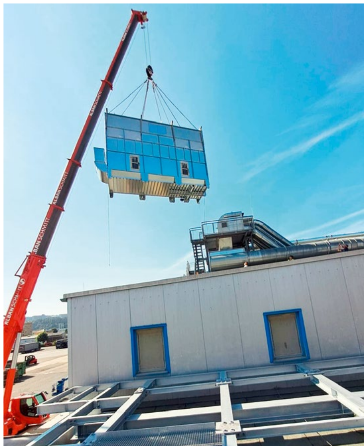
Logistik nach individuellem Wunsch: Die eigenkonstruierten „Jet-Set“-Filteranlagen werden dorthin transportiert, wo sie der Kunde konkret platziert haben möchte.
